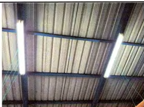
Foto 21 : Sustitución de lamparas led
